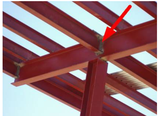
La zona en que se unen la viga y el pilar sufre cizalladura, porque tiende a cortarse
